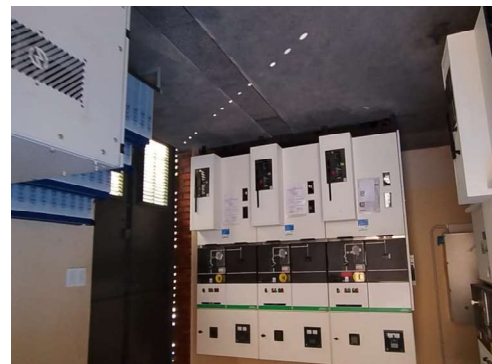
Celdas en 33 y 13,2kV
