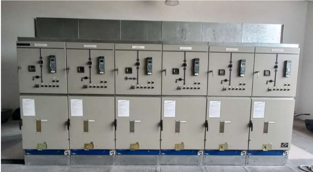
Sala de Celdas – ER Forestal.
