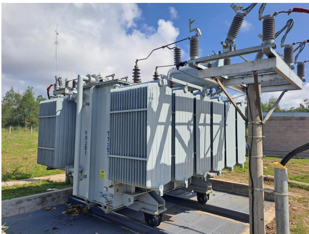
Transformador de rebaje – 33/13,2kV 10MVA RBC
