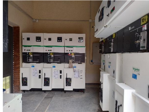
Celdas en 33 y 13,2kV
