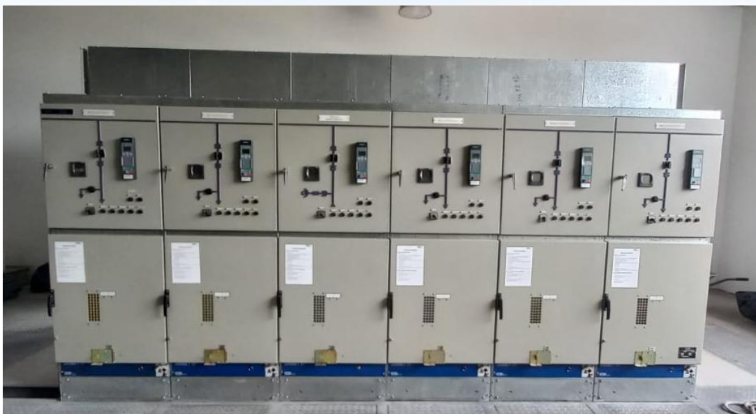
Sala de Celdas – ER Forestal.
