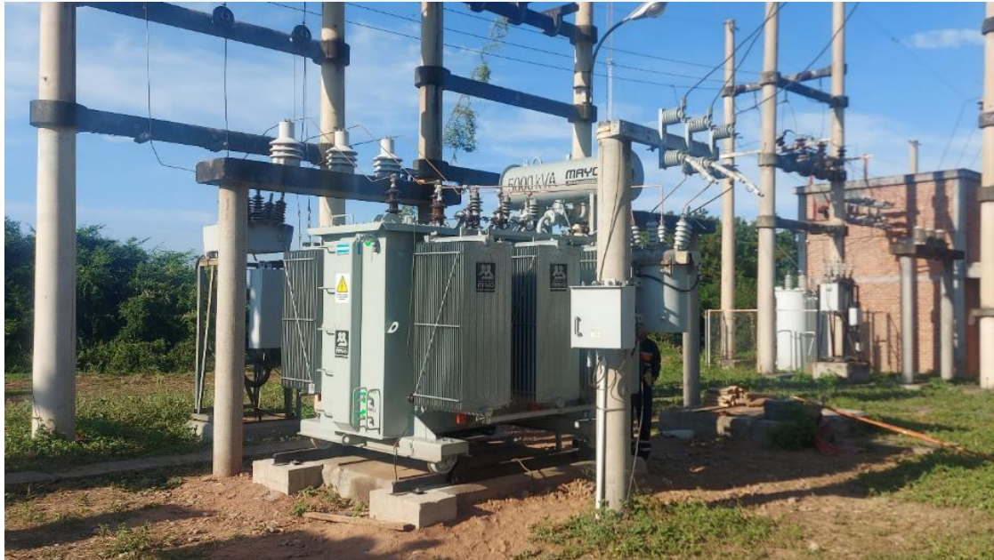
Nuevo Transformador en E.R. Lavayén
